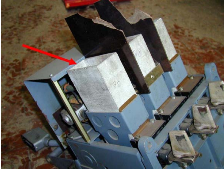
Σχήμα 18.2 Αμιαντούχα στοιχεία σε εξοπλισμό διανομής μεγάλων ηλεκτρικών φορτίων
