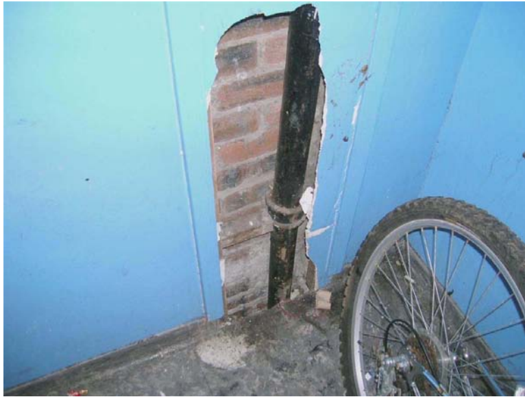
Σχήμα 6.4 Μονωτική αμιαντόπλακα· θα πρέπει να εξεταστεί ως ενδεχόμενο η αφαίρεση, επειδή η αμιαντόπλακα στη θέση αυτή είναι ευάλωτη σε χτυπήματα
