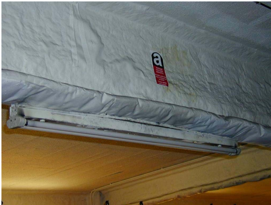
Σχήμα 4.11 Μόνωση από αμίαντο σε δομικό στοιχείο από χάλυβα.
