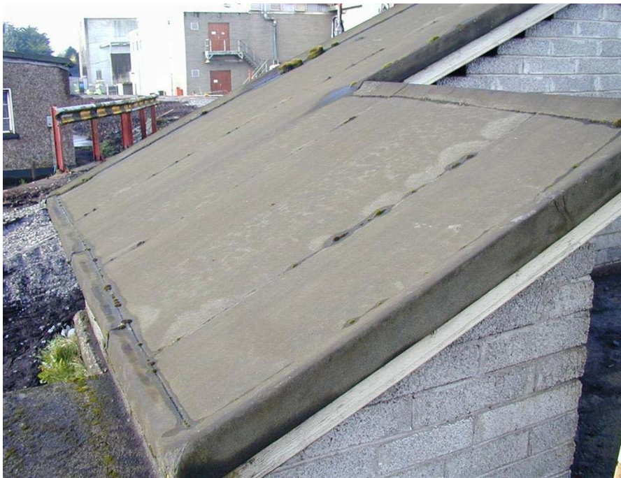
Σχήμα 4.7 Αμιαντούχο ασφαλτόπανο σε στέγη
