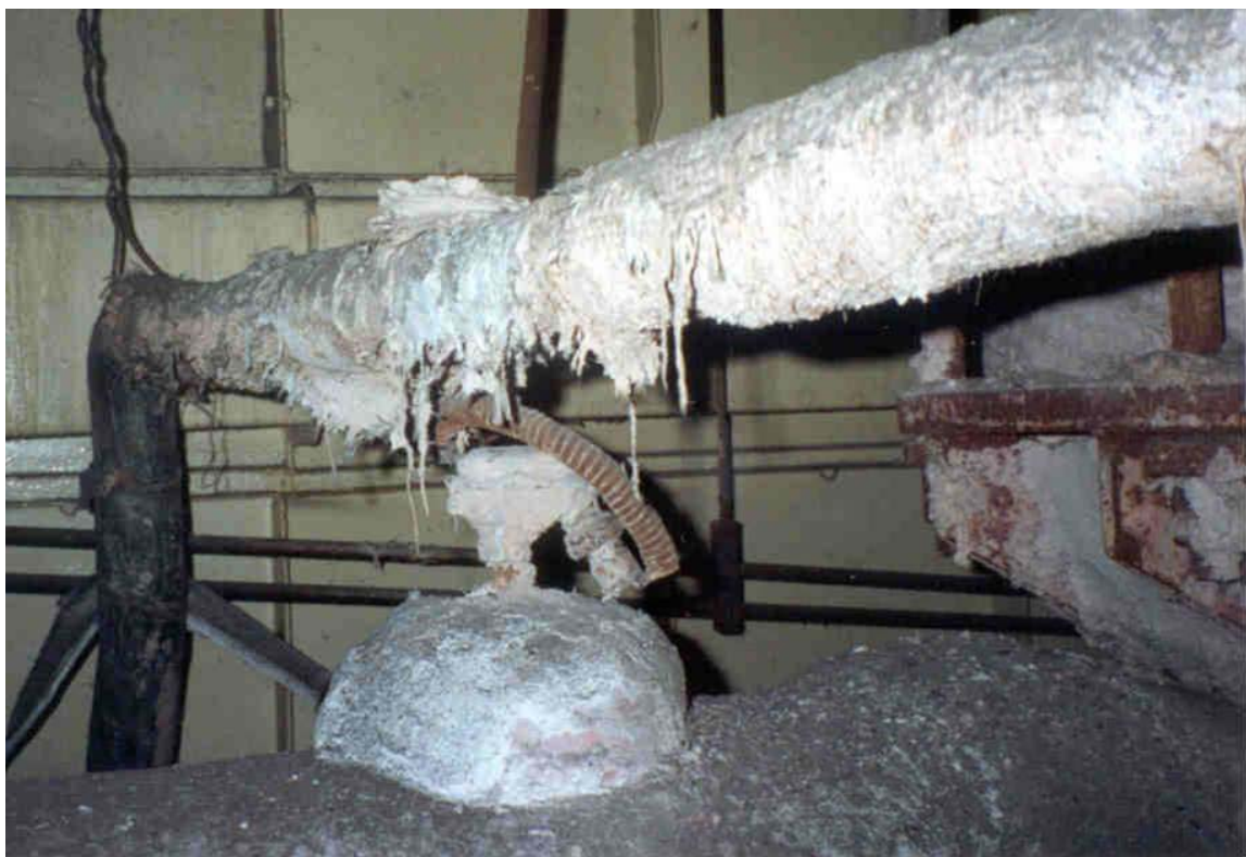
Σχήμα 4.8 Μόνωση από αμιάντο σε σωληνώσεις ατμού
