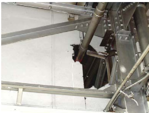
Σχήμα 4.3 Μεσότοιχος από μονωτική αμιαντόπλακα. Το παράδειγμα αυτό δείχνει τις πρακτικές δυσκολίες για την κατασκευή κατάλληλου περιβλήματος και επίσης δείχνει τις επιφάνειες στις οποίες μπορεί να συγκεντρωθεί σκόνη αμιάντου κατά τη διαδικασία αφαίρεσης.
